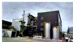
バイオマス発電施設 (DSグリーン発電米沢合同会社:米沢市)
